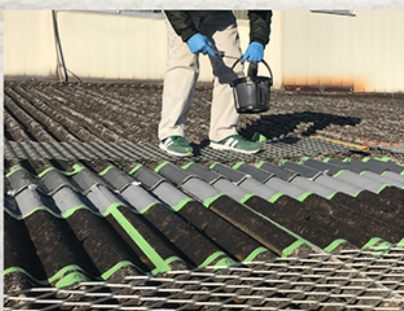
①テスト施工 黒く見える箇所がリセタープロ施工後の様子(2回塗り) グレーの箇所がアスガード施工の様子
